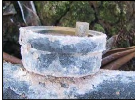
Gotero obstruido por precipitaciones de cal
