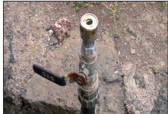
Conexión a un equipo fijo
